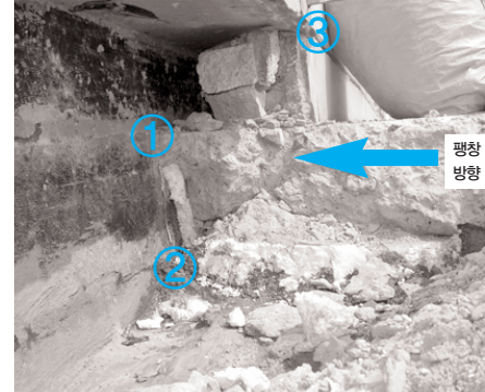
[그림 5] ①, ②번 스티로폼 설치 불량 및 ③번 보호벽 설치 미흡
