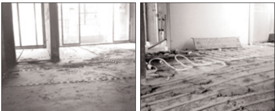
(a) 완충재가 들뜬 상태 (b) 방열관 고정 불량
