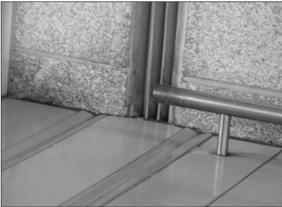
벽체와 바닥이 만나는 조인트의 크기가 달라 보이지만 커버재가 있어서 그렇게 보일 뿐이며 벽과 바닥의 내부 장치 충격흡수율은 같아야 함.
