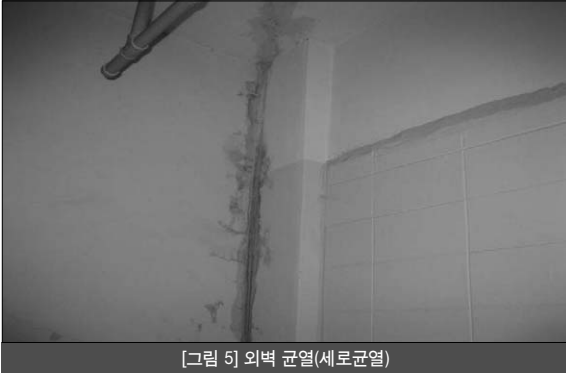
[그림 5] 외벽 균열(세로균열)
