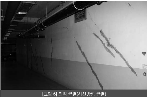
[그림 6] 외벽 균열(사선방향 균열)
