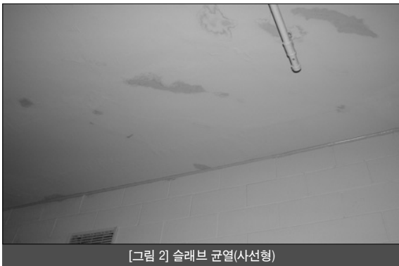
[그림 2] 슬래브 균열(사선형)
