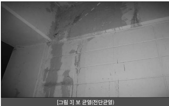
[그림 3] 보 균열(전단균열)
