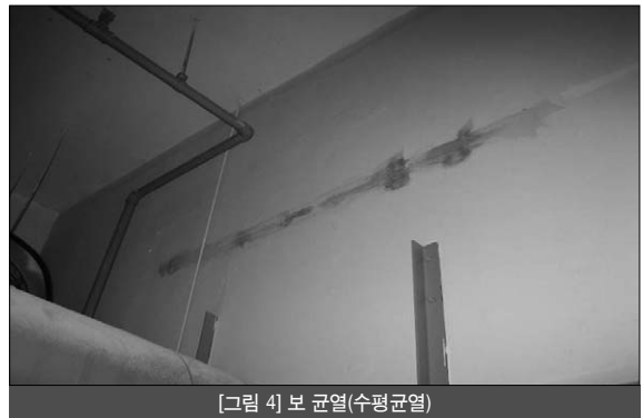
[그림 4] 보 균열(수평균열)
