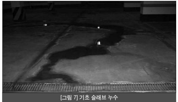
[그림 7] 기초 슬래브 누수
