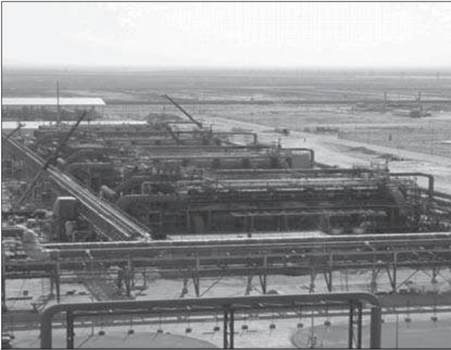
[그림 9] Az-Zour Desalination Plant, Kuwait (두산중공업, 1999년~2002년)
